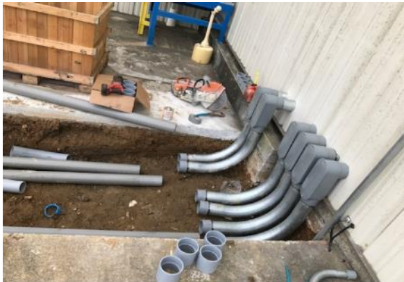
Electrical Servicing Conduits
