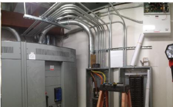
Conduits Servicing Switchgear
